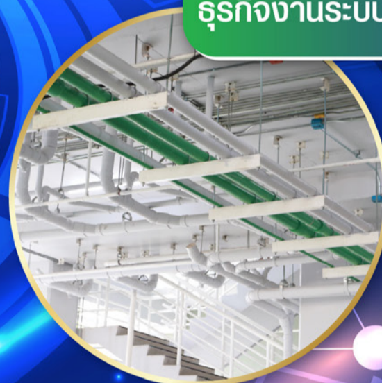
ธุรกิจงานระบบไฟฟ้า-ประปา
