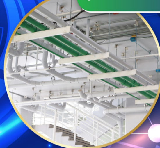
ธุรกิจงานระบบไฟฟ้า-ประปา
