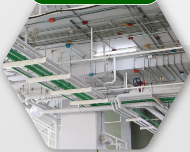
ธุรกิจงานระบบไฟฟ้า-ประปา
